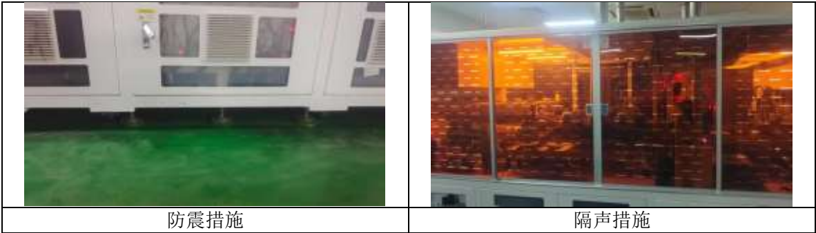
图3-2 噪声治理措施现场照片
