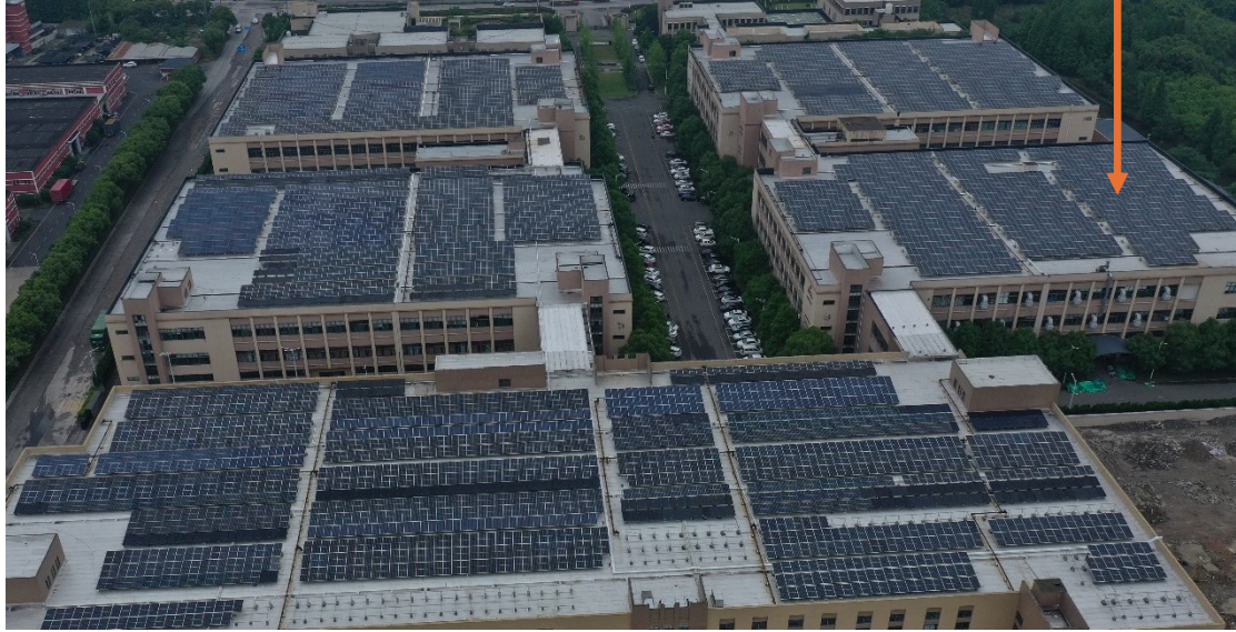
图 18 宁波杭州湾新区奥博汽车屋顶分布式项目
