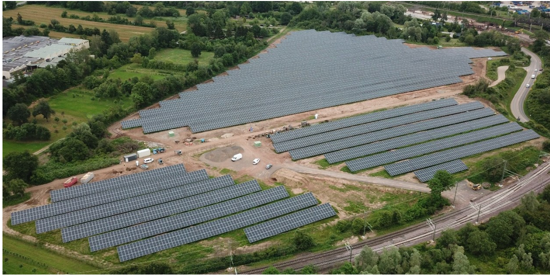
图 20 德国特里尔地面电站项目
